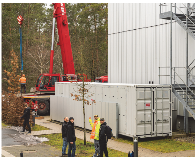
Schweres Gerät war erforderlich, um den Testcontainer neben der Mittelspannungshalle des IISB zu platzieren (Bild: Thomas Richter / IISB).
